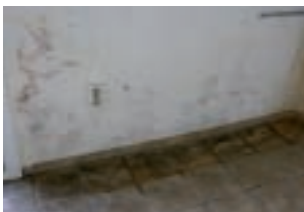
Schimmelpilzbefall einer Aussenwand Quelle: Stadt Oberhausen
