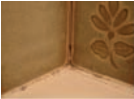
Befall einer Silikonfuge, Quelle: Stadt Oberhausen
