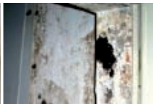
Schimmel-Wasserschaden Quelle: www.enius.de
