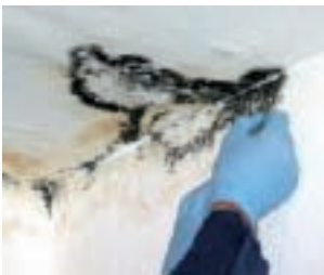
Entnahme einer Kontaktprobe von Schimmelpilzen Quelle: www.enius.de
