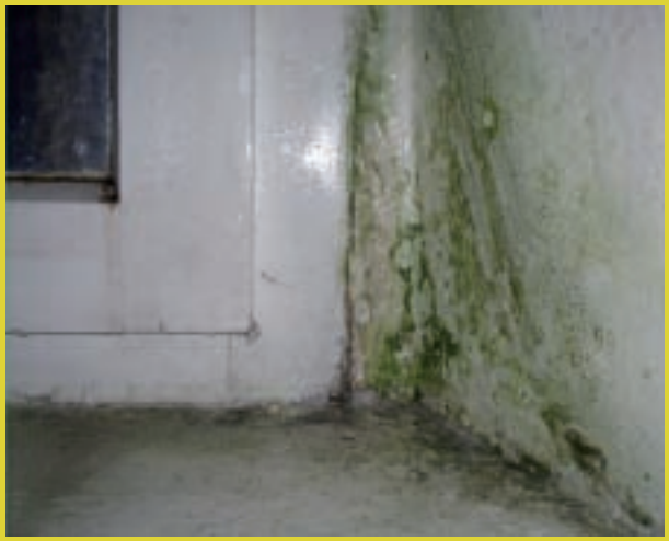
Schimmelbefall von Putz - Quelle: JatiProducts
