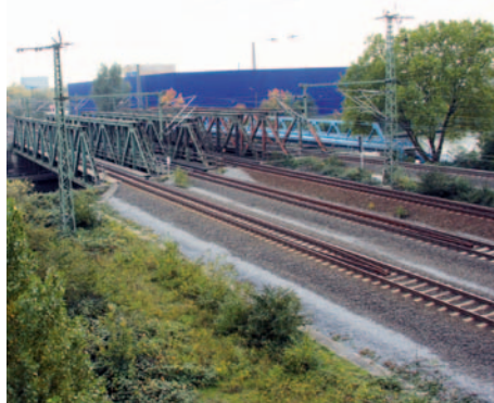
Im Bereich des Rhein-Herne-Kanals wird das Brückenbauwerk an den viergleisigen Ausbau angepasst.
